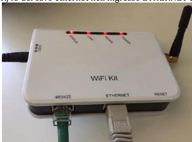
Figura 81 – Cavo ethernet connesso al datalogger
