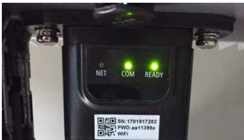
Figura 64 - Stato iniziale dei LED
